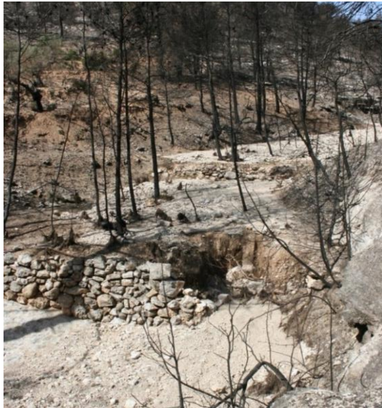
FOR-2. Muro de bancal parcialmente arrastrado por la corriente de las últimas lluvias. Aguas arriba se aprecia una importante sedimentación de piedras y gravas.
